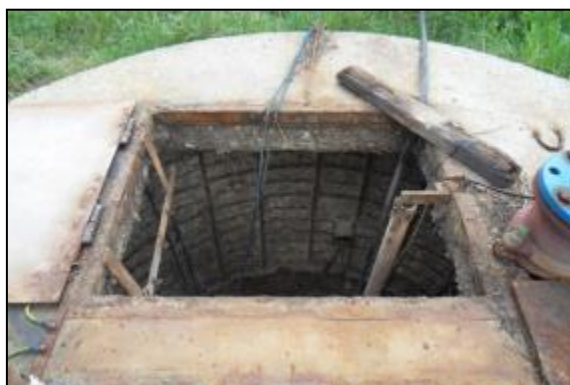
Az 1. sz. átemelő szivattyúaknája
