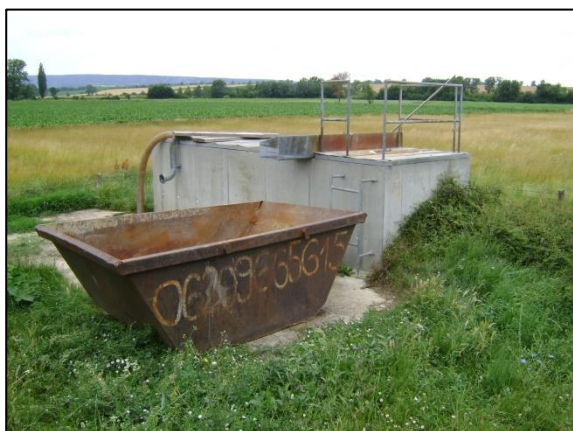
Szippantott szennyvíz fogadó akna
