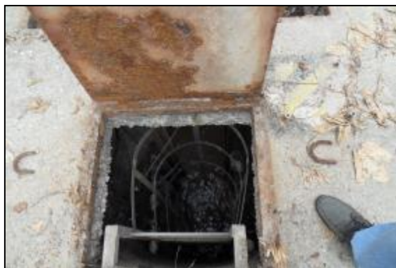
Az 5. sz. átemelő szivattyúaknája
