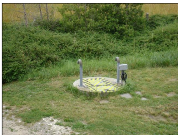
Csurgalékvíz átemelő akna
