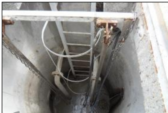
Az 4. sz. átemelő szivattyúaknája
