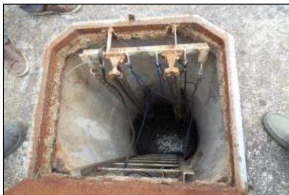
Az 2. sz. átemelő szivattyúaknája
